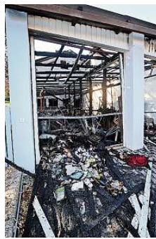
Völlig zerstört: die Garagen, bei denen das Feuer ausgebrochen ist.
