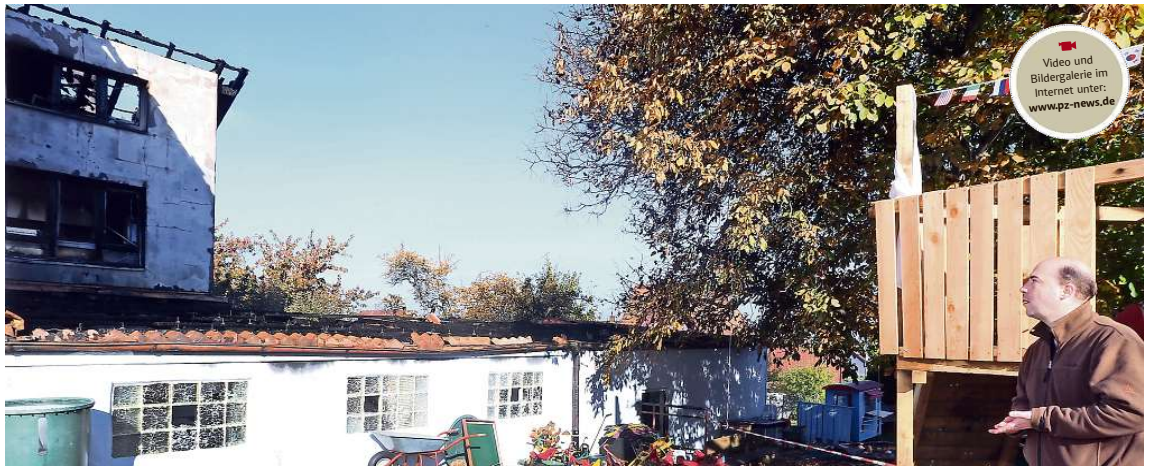
Pfarrer David Gerlach begutachtet am Tag nach dem Brand die Schäden im evangelischen Gemeindezentrum in Conweiler.
